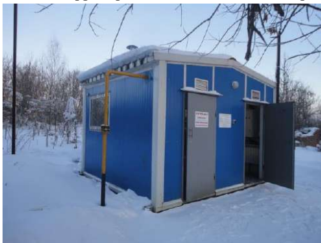
Рисунок 1.2.109 - Общий вид котельной 18в д. Богдановка.
