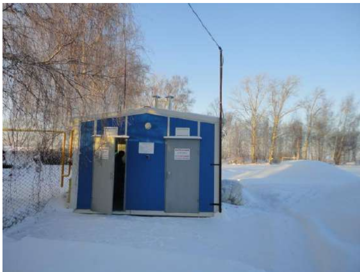
Рисунок 1.2.107 - Общий вид котельной 18а «школа» п. Правдинский
